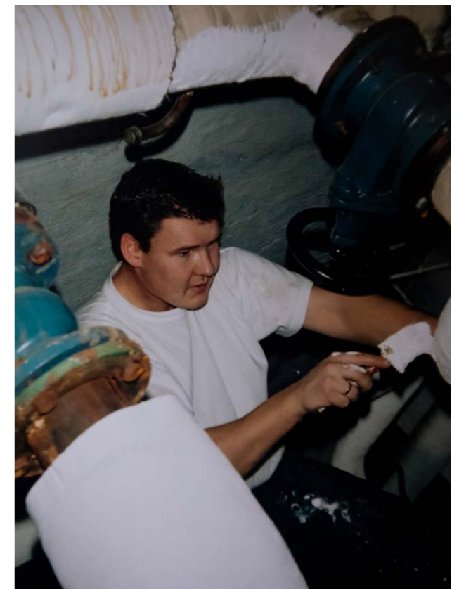
OPPGRADERT: Siden dette bildet ble tatt er det gamle fyringsanlegget blitt byttet ut med vannbåren varme. Foto: privat
