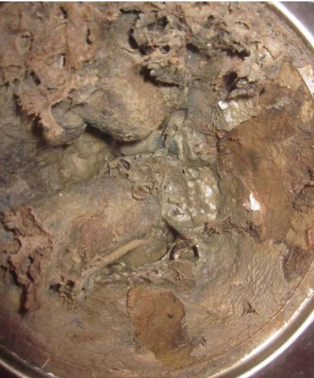
FØLG MED: Bildene viser resultater av for dårlig vedlikehold over tid. Sprukne og tette rør er blant annet en gjenganger. Foto: ABBL
